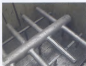
Dispensore-diffusore acque reflue in acciaio di diverse dimensioni su letto filtrante
