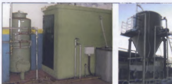
Impianti C.F. per trattamento scarichi industriali
