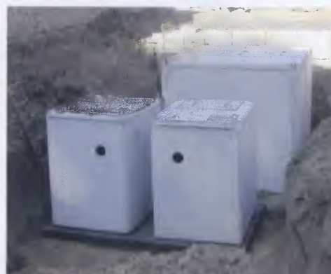
Impianto trattamento acque meteoriche
