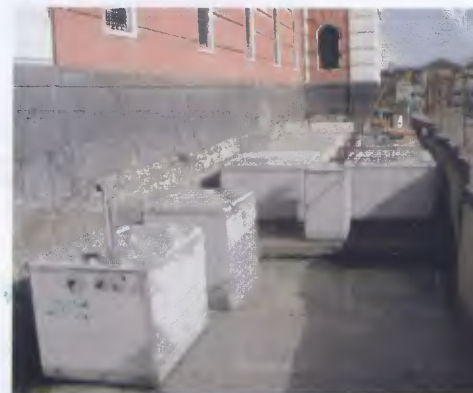
Impianto biologico a fanghi attivi
