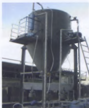
Impianto di depurazione a recupero di acque di scarico attività di lavorazione prefabbricati in c.a.v. sedimentatore in acciaio al carbonio da utilizzare con sistema combinato chimico-fisico.
