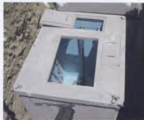
Impianto trattamento acque meteoriche
