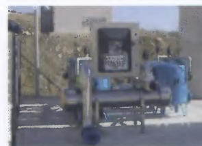
Trattamento terziario per il riutilizzo delle acque con sistema di decontaminazione mediante filtrazione automatica e trattamento UV.
