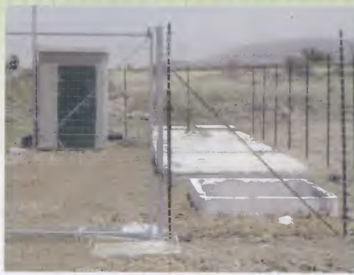
Impianto seminterrato con locale tecnico
