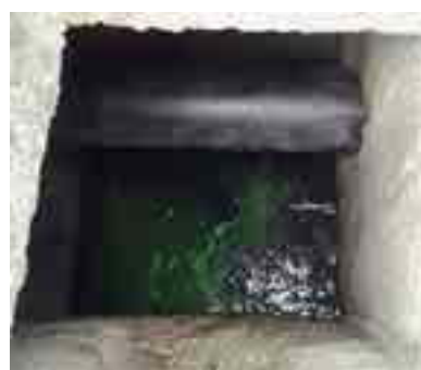
UNO DEI POZZETTI DI SAN LEONE
